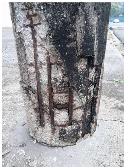
Figura 1. Corrosão avançada das armaduras de um elemento de concreto armado
