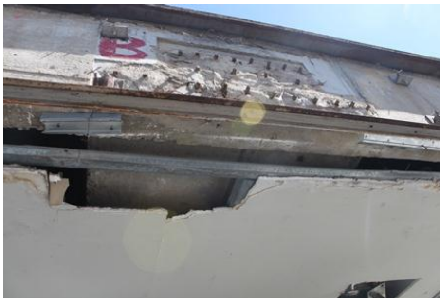
Figura 9. Detalhe da viga protendida (dente Gerber) da marquise: Autores
