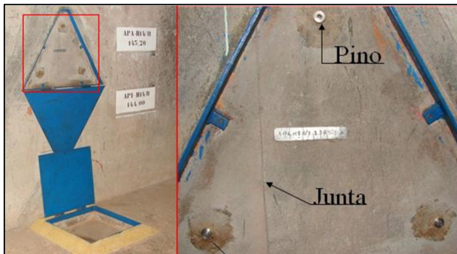
Figure 3. Foto de bases de alongâmetro instaladas no piso e na parede
