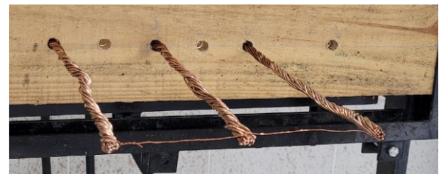
(c) Cabos de cobre.
